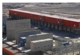
SUBESTACIONES / SALAS ELÉCTRICAS
