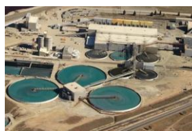
TRATAMIENTO AGUA / EFLUENTES
